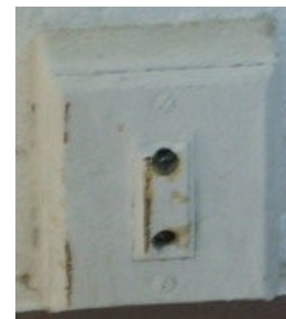
Prise électrique sans borne de terre
